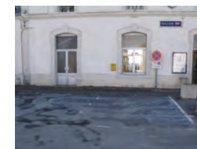
Le traitement des aménagements (ici places PMR) reste de mauvaise qualité
