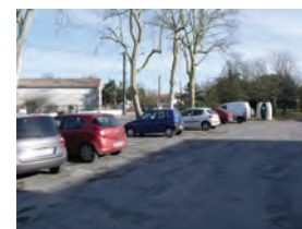
Un revêtement stationnement peu confortable pour les piétons
